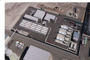
姫路第二発電所の水素製造装置
