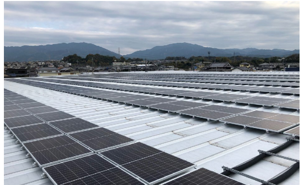
トライアルカンパニーさまの屋号と太陽光パネル
