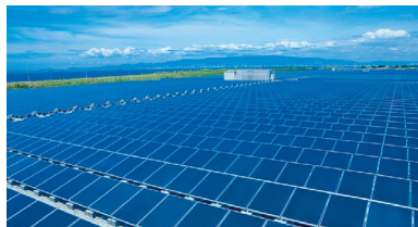
堺太陽光発電所
