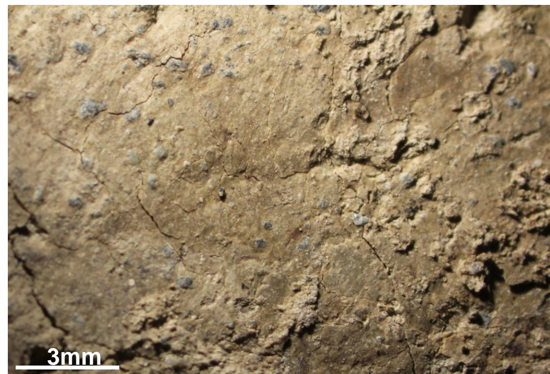
断層面の状況
