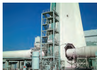
●南港発電所排煙脱炭プラント
