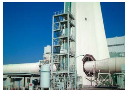
●南港発電所排煙脱炭プラント
