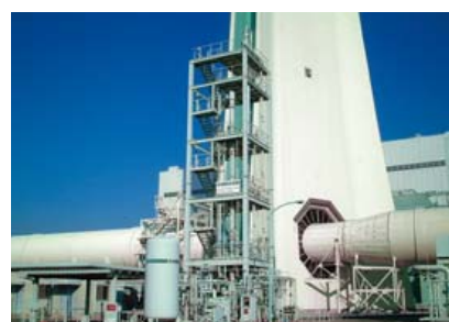
●南港発電所排煙脱炭プラント
