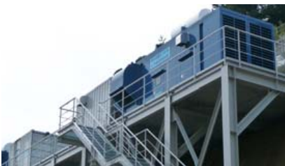
●空冷式非常用発電装置
