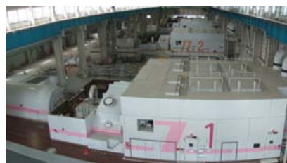
●コンバインドサイクル発電設備 (堺港発電所)
