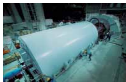
●コンバインドサイクル発電設備（堺港発電所）
