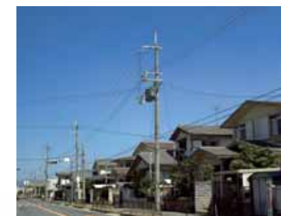
●電柱と変圧器
