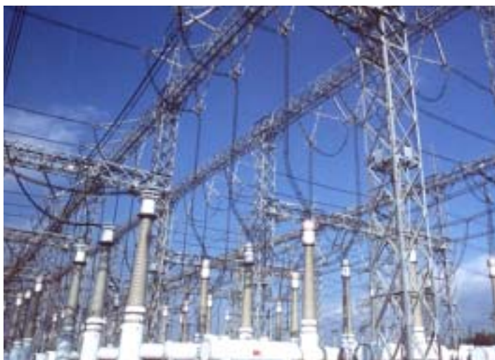
新生駒変電所
