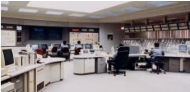
写真上から 姫路第一発電所（火力）/総発電出力144.2万kW 姫路LNG管理所指令室
