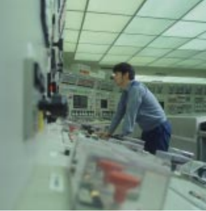
中央制御室 (高浜発電所/原子力)
