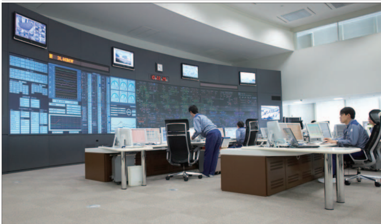
電力需要の変化を監視し、必要な発電量を各地の発電所に指示する「中央給電指令所」
