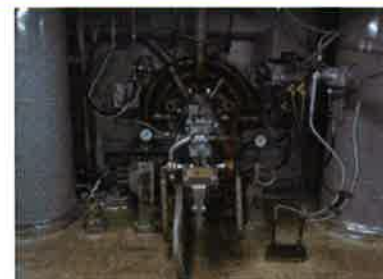
③ボイラ改造 (バーナ入替他)
