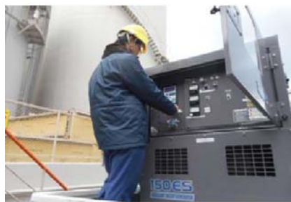
蒸気発生器への給水訓練の様子
