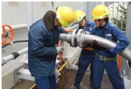
蒸気発生器への給水訓練の様子
