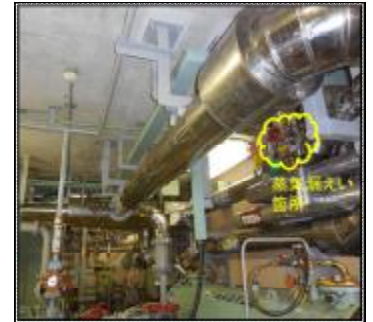
&lt;蒸気漏れ箇所の写真&gt;
