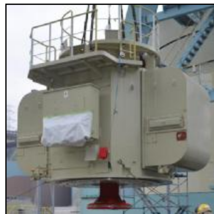
【故障した循環水ポンプのモーター部分】
