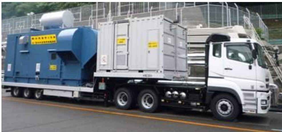
空冷式非常用発電装置
