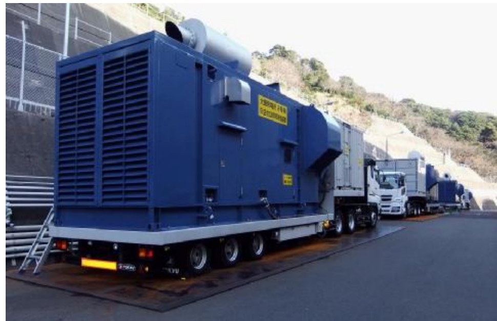
空冷式非常用発電装置
