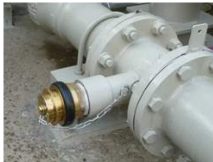
改善事例1: 復水タンクの接続口
