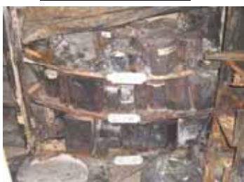
火災後の塗料棚の写真
