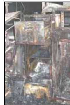
火災後のキャビネットの写真
