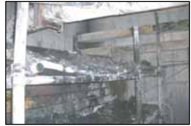
火災後の棚中段の写真
