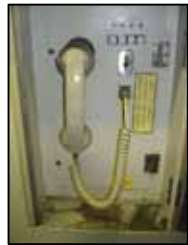
熱によりハンドセット中の基板等が損傷
