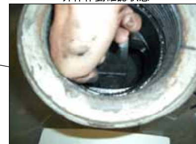
弁体作動確認状態
