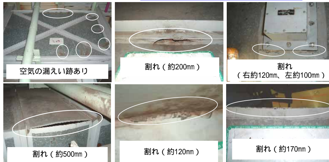
補助建屋排気ダクト損傷箇所
