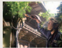
【左】 天乃神社（大阪府） の電気設備点検
