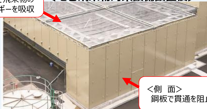
〔竜巻飛来物対策設備設置後〕
